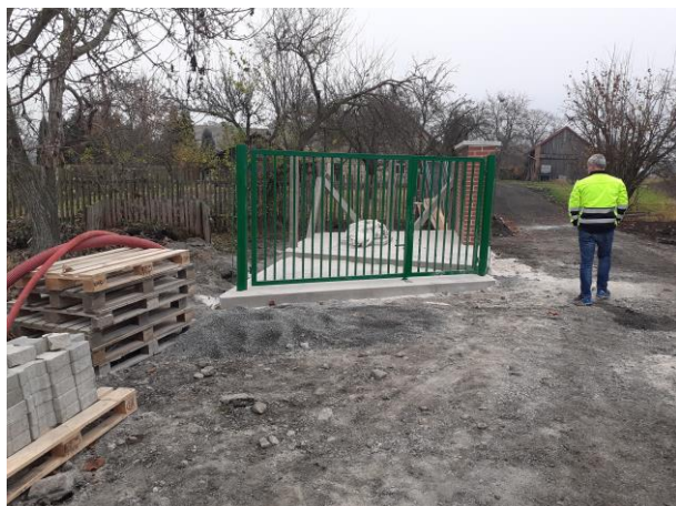
Dokončená ČS Chaloupky
