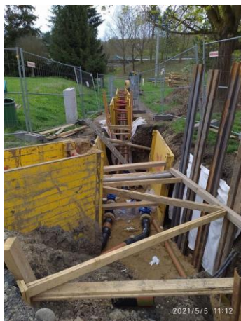
Armaturní uzel - výtlak Krnsko
