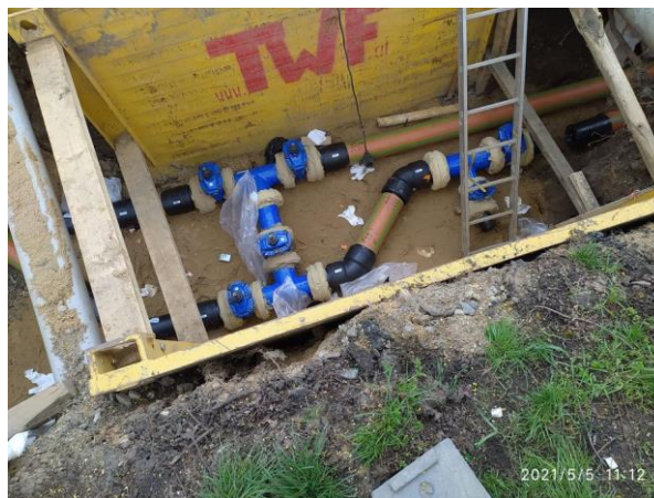
Armaturní uzel - výtlak Krnsko
