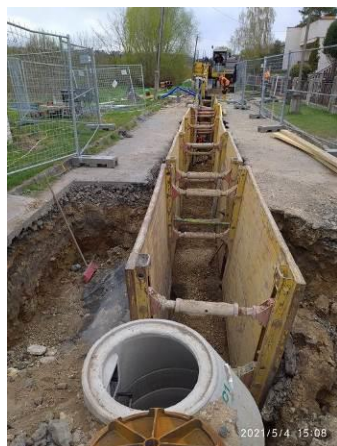
Kanalizační stoka H
