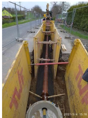
Kanalizační stoka G2-1-1 v ul.RA
