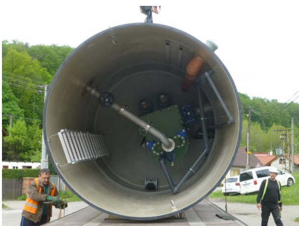
Čerpací stanice ČS2
