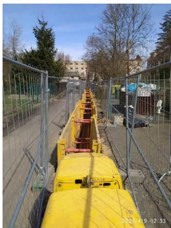
Výtlačný řad - Vinec
