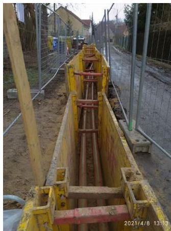
Výtlačný řad Vinec
