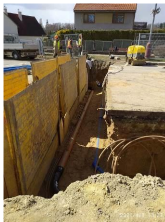
Výtlačný řad Brodce ul.RA
