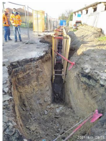
Kanalizační stoka G2-1-1
