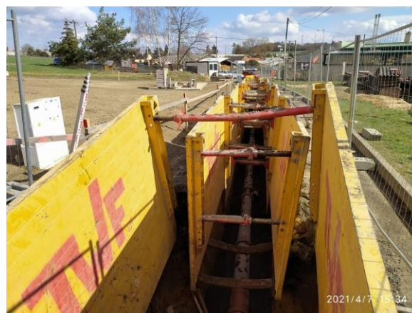
Kanalizační stoka G3
