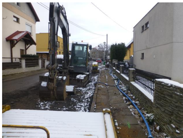
Stoka BB provizorní vodovod
