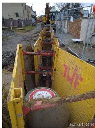
Kanalizační stoka F
