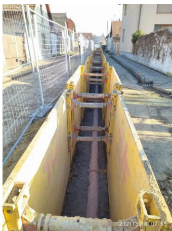
Kanalizační stoka F11
