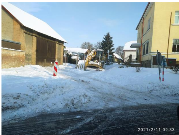
Kanalizační stoka 2S
