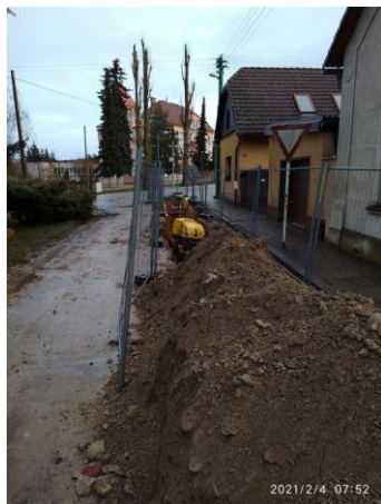
Kanalizační stoka G2-1
