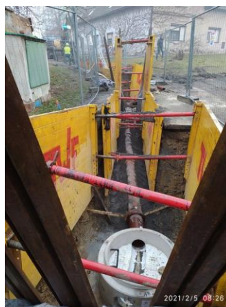
Kanalizační stoka G2-2
